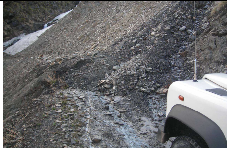
Desprendimiento en La Rinconada 24-4-13
